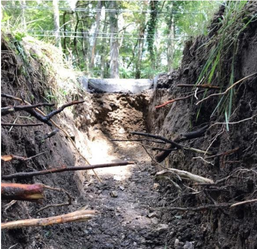
Figure 11. Photo illustrant la présence de racines au niveau des accotements bordés de bois très denses
