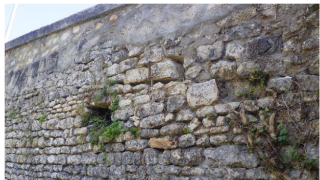
Figure 2. Etat du mur en 2021
