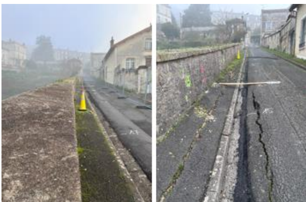
Figure 3. Déversement du mur et affaissement
