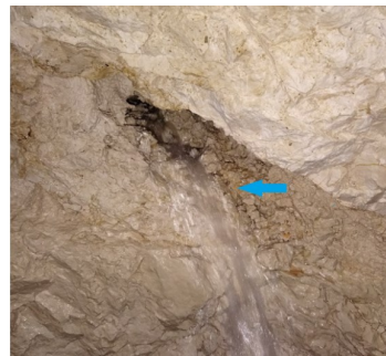
Figure 9. Erosion des matériaux de remplissage dans le rocher de fondation du barrage d'Enguri
