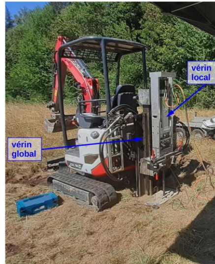
Figure 6. Système de chargement utilisé pour la réalisation des essais CRPT in-situ monté sur une mini pelle mécanique.
