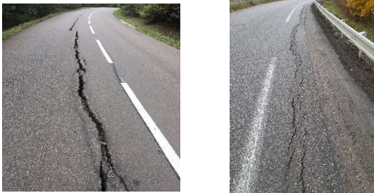
(a) (b) Figure 1 : Exemple de fissure longitudinale due à un RGA (a) et à un glissement de terrain (b). Source : Cerema
