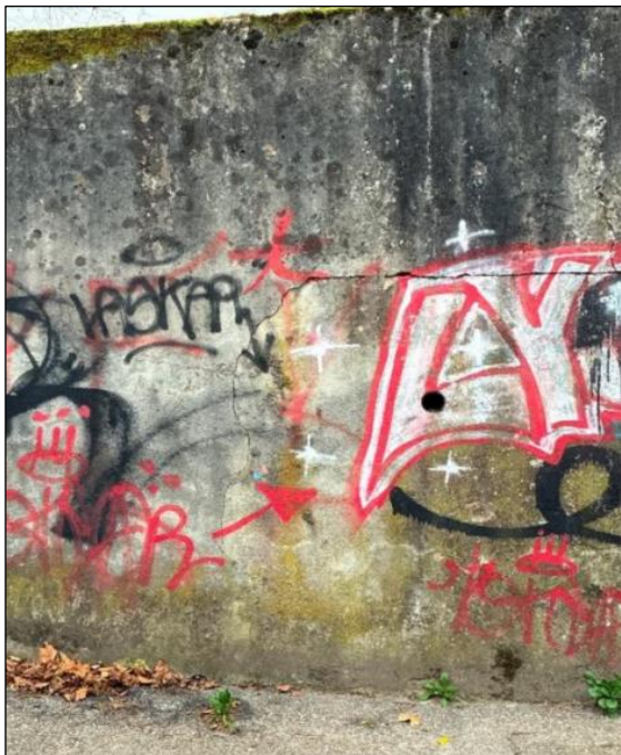
Figure 5. Fissurations d'un mur de soutènement liées à un défaut de gestion des eaux à l'amont
