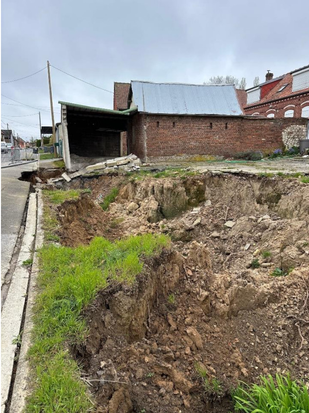
Figure 1: Effondrements survenus en 2023 et 2024 rue Cocriamont à Bienvillers-au-Bois
