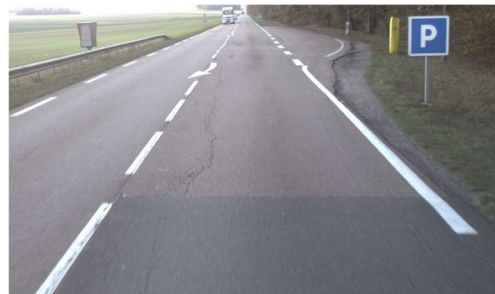
Figure 2 : Photo d'une fissure résultant d'un phénomène supposé de RGA (Image IRCAN 2016 – Cerema Nancy)
