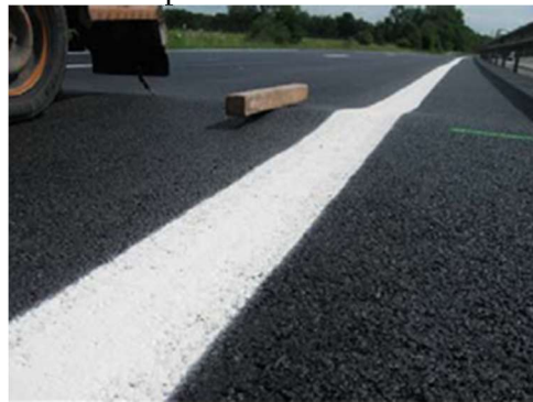
Figure 1 : Photo d'une gonfle au PR 44+230 (Cerema Nancy – août 2013)
