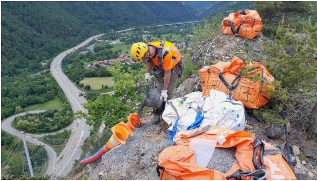
Figure 13 . Mise en œuvre du bourrage depuis la tête de falaise, 50 m plus haut
