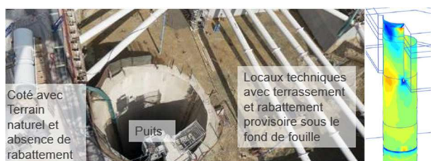
Figure 17. Flexion d'axe verticale dans un puits du Grand Paris soumis à des conditions de terrassement dissymétriques
