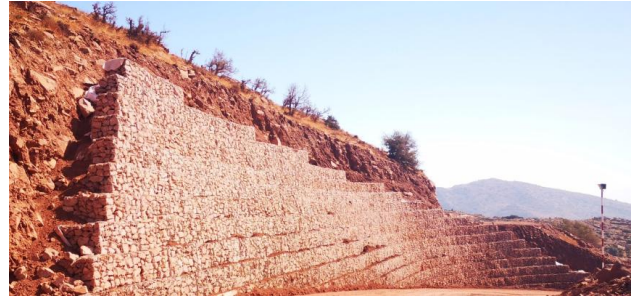
Figure 18 : talus de colluvions conforté avec un mur en gabions
