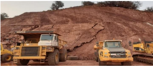
Figure 6 : rupture d'un talus d'argilite après une pluie importante
