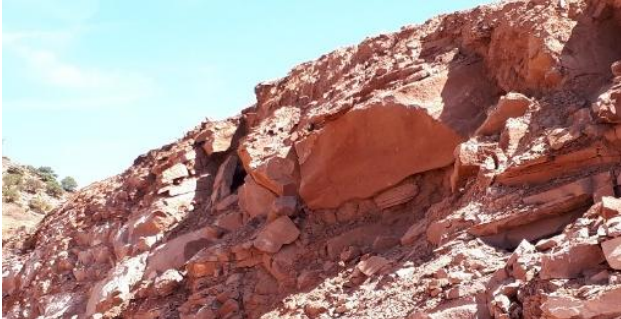
Figure 11 : photographie d'un talus présentant des dièdres et un pendage défavorable
