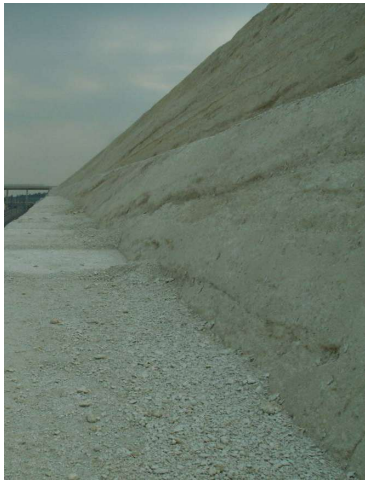
Figure 8. Illustration de la dégradation du talus soumis à un hiver rigoureux (érosion du talus et chutes de petits débris sur la berme).
