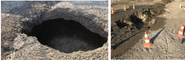
Figure 11. Photographies de l'affaissement localisé observé
