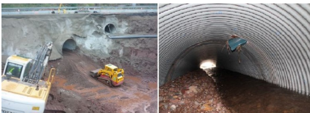
Figure 5. Gunitage au béton projeté du talus et curage de la buse métallique amont non effondrée.
