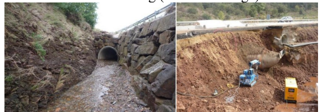
Figure 4. Enrochements libres à l'amont de la plateforme autoroutière, engrèvement du thalweg et granulométrie fine autour du corps de la buse métallique.
