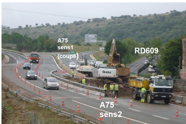
Figure 6. Mesures d'exploitation d'urgence : neutralisation sur une voie du sens 2 (sud-nord). Le sens 1 (nord-sud) est dévié via la route départementale RD609.
