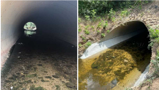
Figure 18. Buse métallique dans un cours d'eau biologique. Reconstitution du lit imposée par les services de police de l'eau de l'État.
